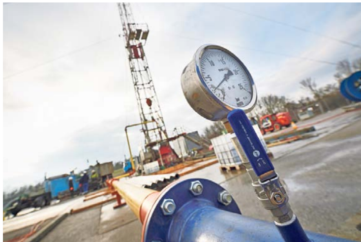
Die finalen Forschungsarbeiten in der Donaustadt liefern wichtige Erkenntnisse für die Zukunft der Geothermie.
