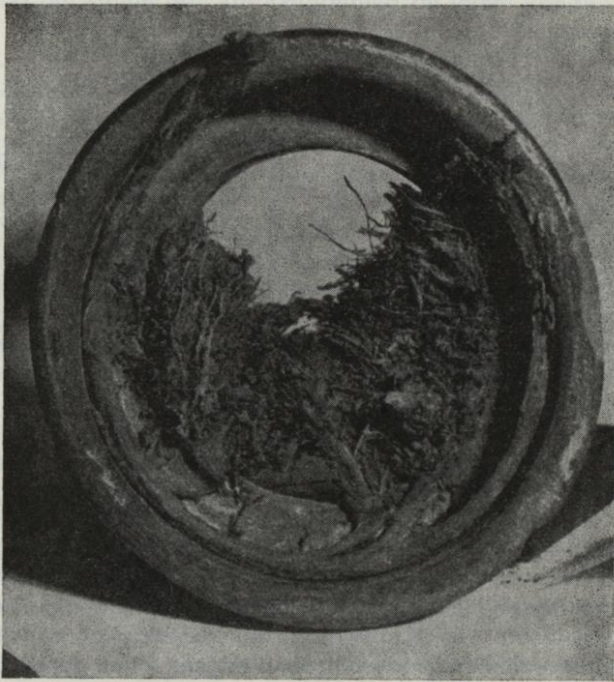
Verwurzelung eines Steinzeugrohres
