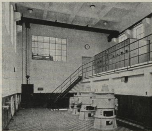
Maschinenhaus Pumpwerk Fännergasse
