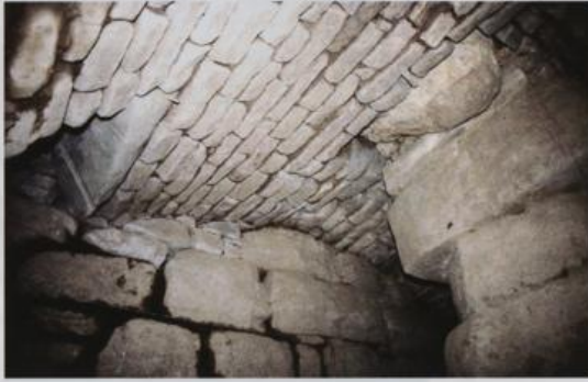
Abb. 25: Sickerkammer unter der Kuretenstraße: Gewölbe der Kammer mit Einmündung des Kanals unter Stiegengasse 1 (links) und Pfeiler
