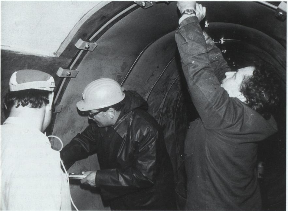
Scheibbs – provisorische Sicherung mit Kunststoffolie
