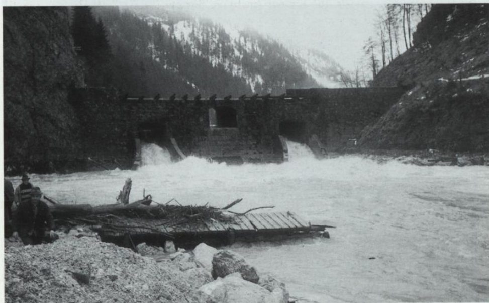
Preszenyklausen: Zerstörung des Vorwehres durch Hochwasser, 1974
