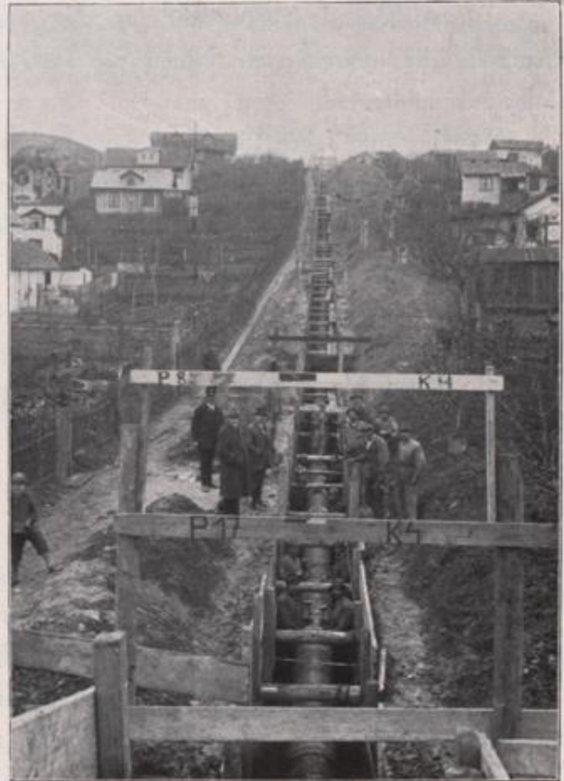
Wasserleitungs-Rohrstrang, 500 mm, über den Ameisberg Wien-Breitensee.
