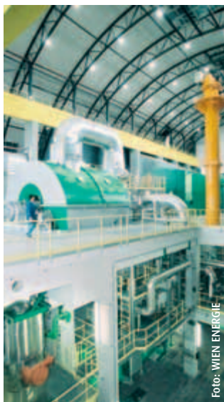
Blick ins Innere des kalorischen Kraftwerks Donaustadt
