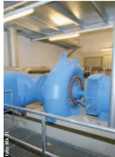
Die neue Turbine im „Trinkwasserkraftwerk Mauer“
