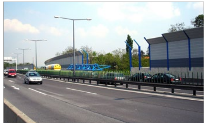
Lärmschutz an der A 23, Simmering.
