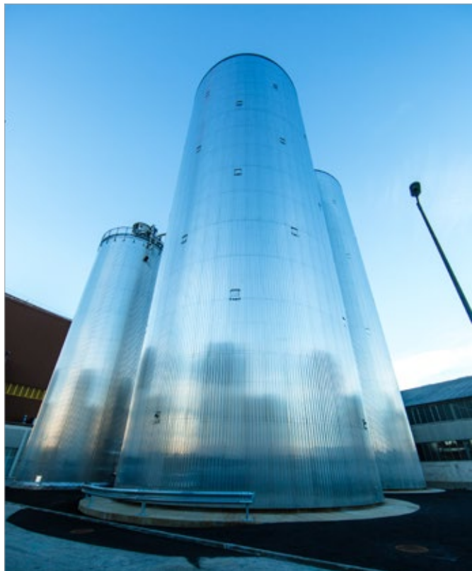
Der neue Hochdruck-Wärmespeicher in Wien Simmering.
