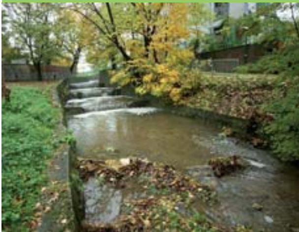
Bestehende, nicht fischpassierbare Absturzbauwerke am Halterbach
