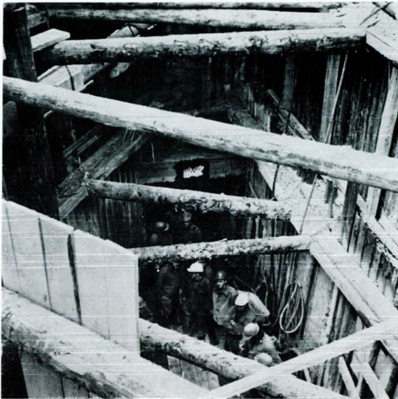
Der Bau des 600 m langen, unter der Hernalser Hauptstraße führenden Alsbach-Entlastungskanal erfolgt im Minierungsverfahren durch Stollenvortrieb
