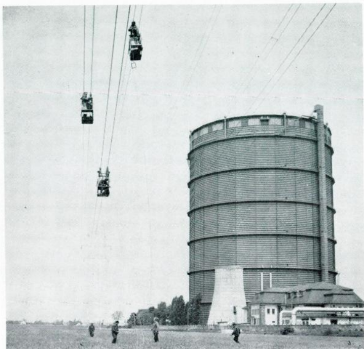
Der Bau der 110-kV-Leitung zwischen den Umspannwerken Leopoldau und Bisamberg ist ein Beitrag zur Sicherung des rasch steigenden Strombedarfs im 21. und 22. Bezirk
