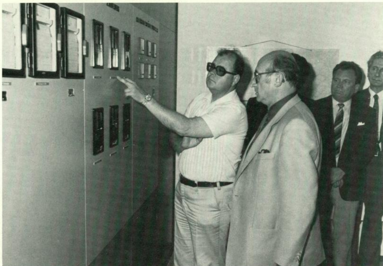
Amtsführender Stadtrat Josef Veleta (Vermögensverwaltung, städtische Dienstleistungen, Konsumentenschutz) besichtigt die Schaltzentrale des Wasserleitungskraftwerkes Hinternaßwald der I. Wiener Hochquellenleitung
