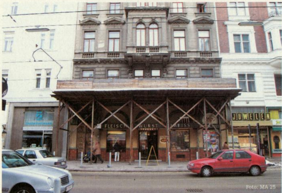
Beispiel einer Notstandspolizeilichen Maßnahme im 8. Bezirk: Sicherung des frei zugänglichen Gehsteigs gegen herabfallende Teile des Hauptgesimses, der Fassade und des Erkers.
