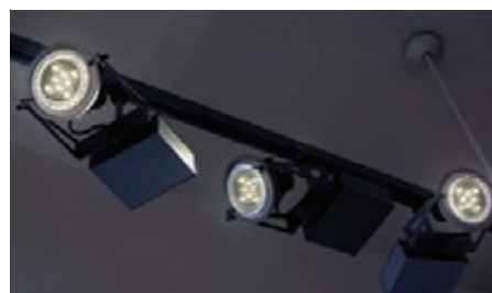
Neue LED-Beleuchtung in der Wiener Planungswerkstatt © Christian Fürthner
