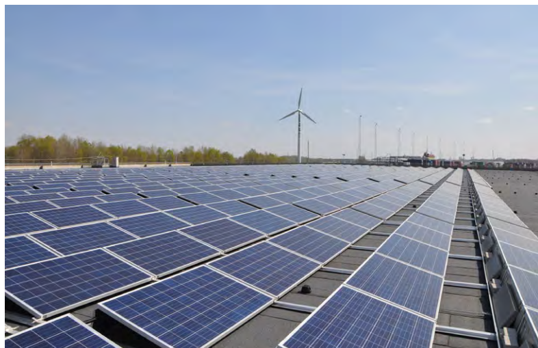
Photovoltaikanlage am Dach des Autoterminals am Hafen Freudenau © Eva Kelety
