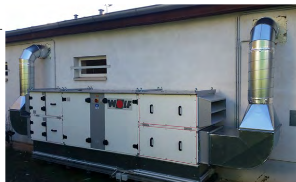
Die neue Lüftung mit Wärmerückgewinnung in der Sportanlage Grinzing Straße © Hödl (MA 51)
