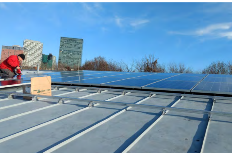
Photovoltaik auf der Sportanlage Eibesbrunnnergasse © MA 51
