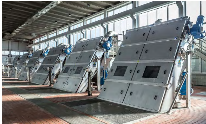
Die erneuerte Grobrechenanlage der ebswien hauptkläranlage © Christian Houdek
