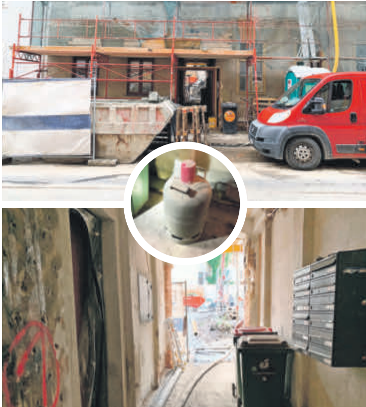
Auf einer Baustelle in einem Hernalser Wohnhaus stand eine offene Flüssiggasflasche. Mitarbeiter des Stadtservice Wien haben die Gefahr gebannt.
