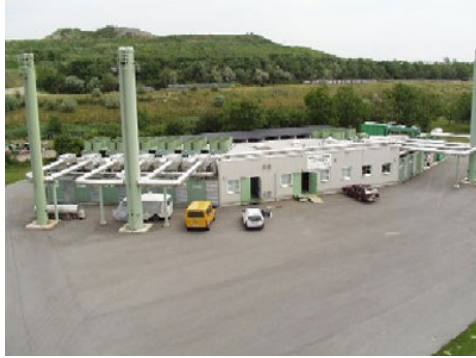
Abbildung 38: Deponiegas-Verstromungsanlage Rautenweg. © Foto: Firma Steiner Bau GesmbH.
