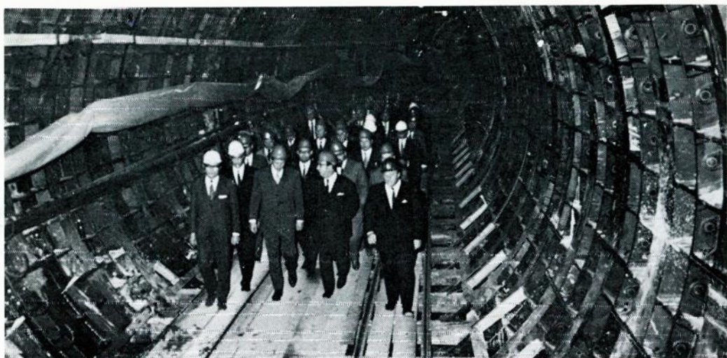
Der erste Wiener U-Bahn-Tunnel ist fertig; er ist 491,6 Meter lang und führt vom Karlsplatz zur Paulanerkirche
