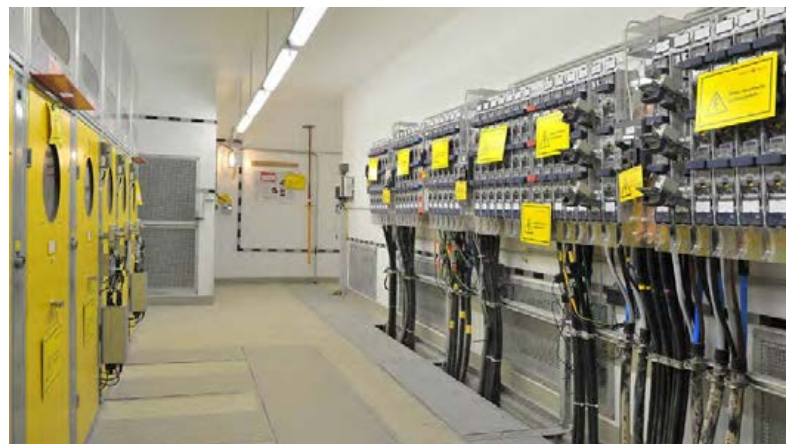
Trafostation mit intelligenten Komponenten © Walter Schraub Walzer (PID)
