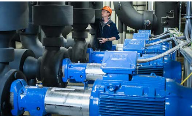
Die Netzpumpen für die Fernkälteversorgung © Ian Ehm (Wien Energie)
