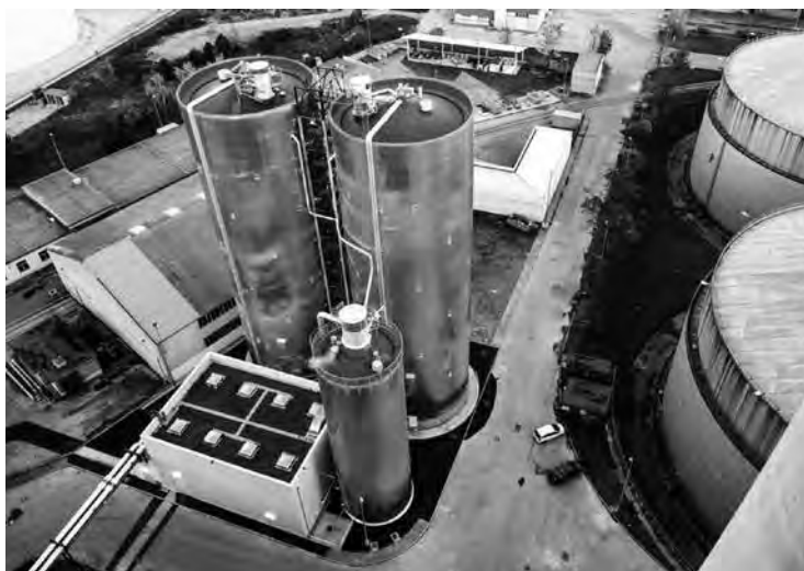
Der Hochdruck-Wärmespeicher in Simmering © Wien Energie/EHM
