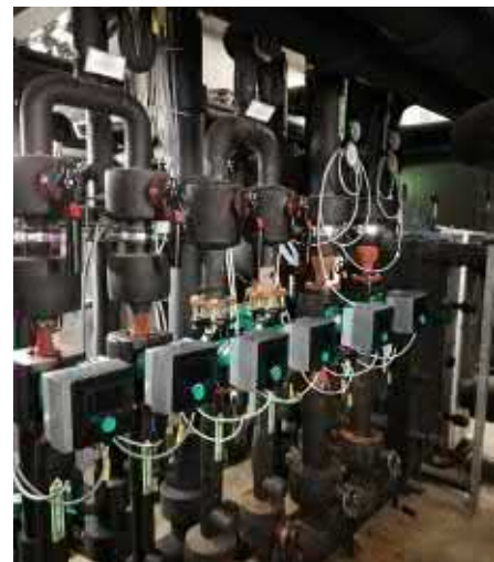
Neue Pumpen sparen Energie beim Kühlen
