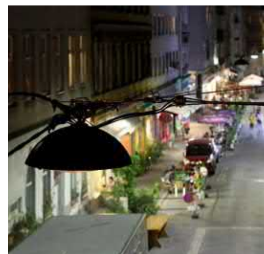
Die Seilhängeleuchten werden kontinuierlich erneuert
