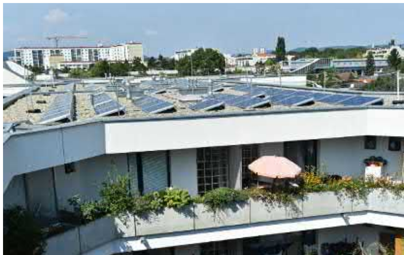
Die Photovoltaikanlage am Schöpfwerk
