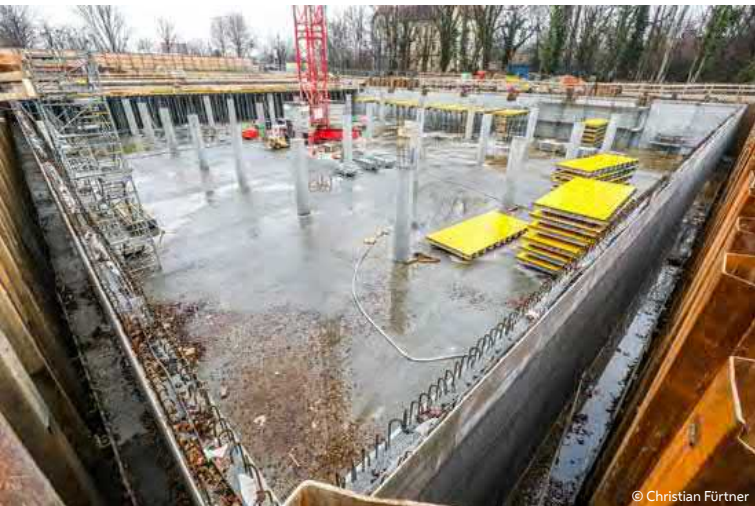
Das Speicherbecken hält Starkregen im Zaum
