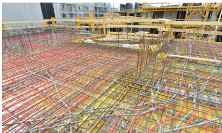
Hier sind die Rohrregister zu sehen, in denen je nach Heiz – oder Kühlzweck warmes oder kaltes Wasser fließt. © MA 20/A. Kromus
