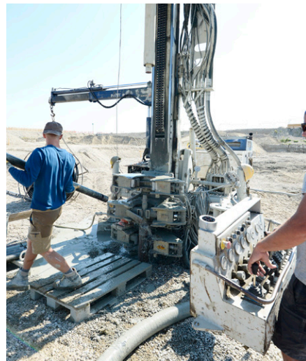
Schritt 4: Rechts im Bild ist die Steuerkonsole, mit der das Bohrgerät händisch bedient wird. An einem Tag können pro Bohrgerät bis zu zwei Sonden ins Erdreich eingebracht werden.
