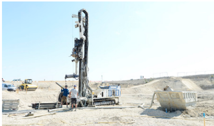
Schritt 3: Das Bohrgerät befördert die Sonden stückweise ins Erdreich. Insgesamt sind über 9.000 Hebelbewegungen notwendig, um eine Sonde 150 m in den Boden zu bringen.
