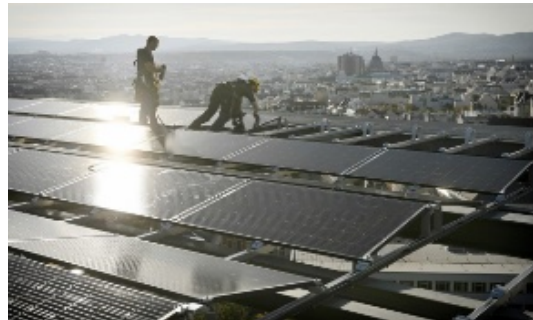
Abbildung 34: Wiener Stadtwerke, Solarkraftwerk
