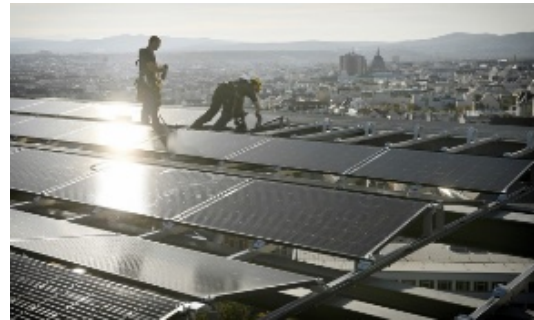
Abbildung 34: Wiener Stadtwerke, Solarkraftwerk
