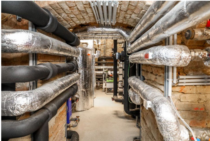
Abbildung: Innovative Energieversorgung für Magistratsgebäude. © Stadt Wien – Energieplanung/Christian Fürthner
