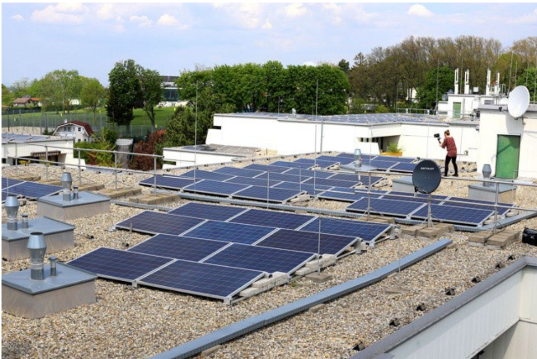
Abbildung: Die PV-Anlage auf dem Gemeindebau Ameisbachzeile. © Votava
