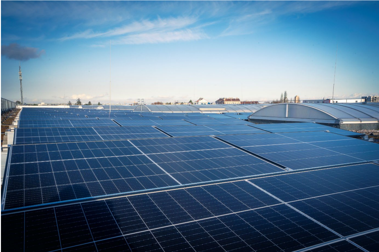
Abbildung: Das Photovoltaikdach der Hauptwerkstätte der Wiener Linien. © Michael Horak, Wien Energie
