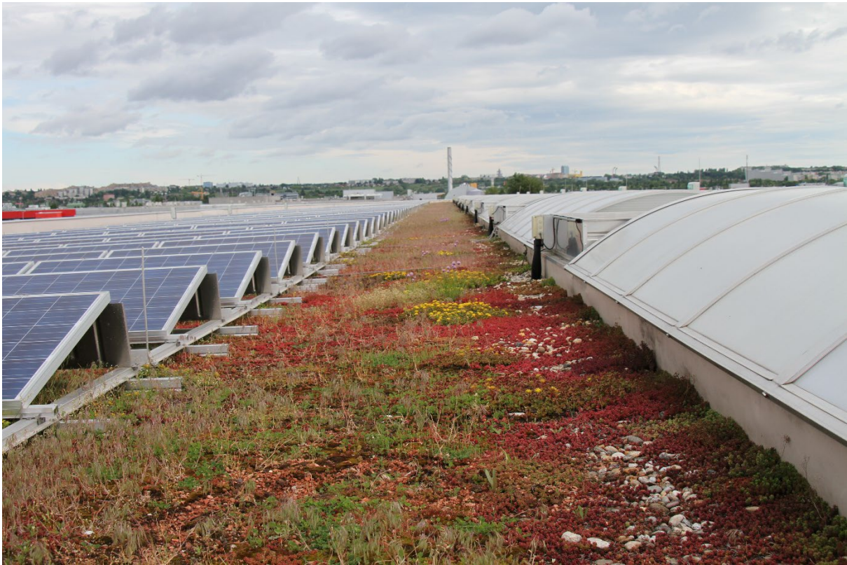
Abbildung: Die PV-Anlage am Postverteilzentrum in Inzersdorf. © Manfred Schönwälder, Stadt Wien – Umweltschutz
